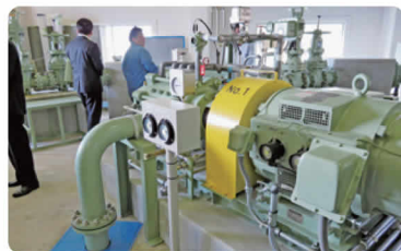
右岸3号用水機場
