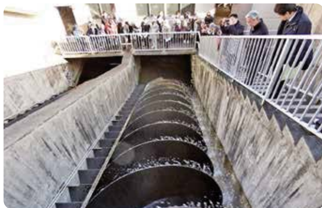
明神ポンプ場
