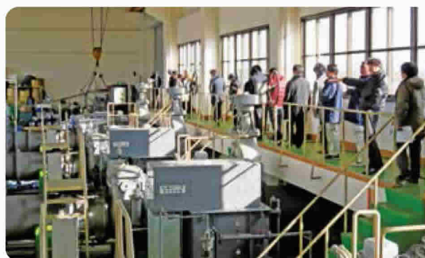
野洲川揚水機場
