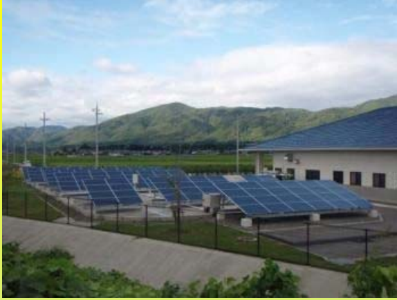
集落排水処理施設の 水槽上部を利用した事例 〔京都府 亀岡市〕
